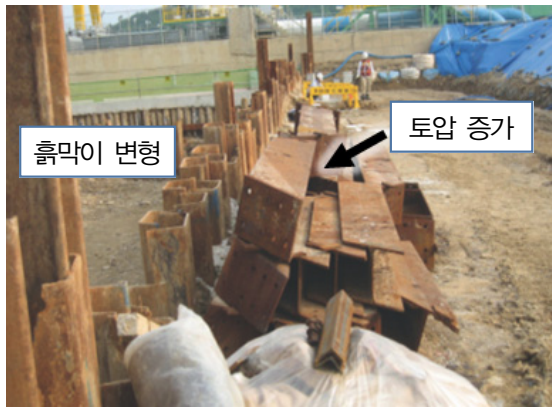
흙막이 배면 자재적치로 인한 토압증가
