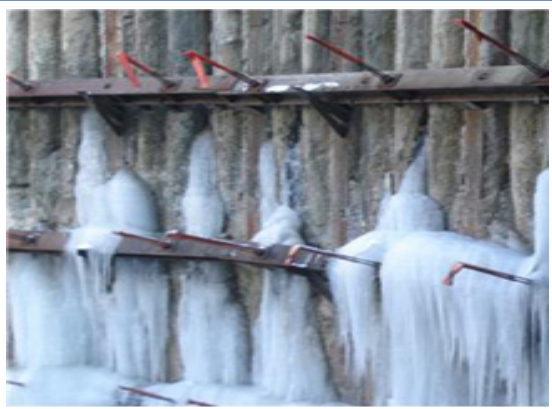
흙막이 벽체의 지하수 유입 및 토사유출
